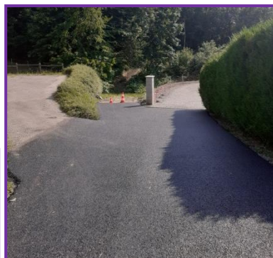
Travaux d'enrobés sur le Chemin du Buisson et sur l'entrée du Chemin de Côte Cheney
