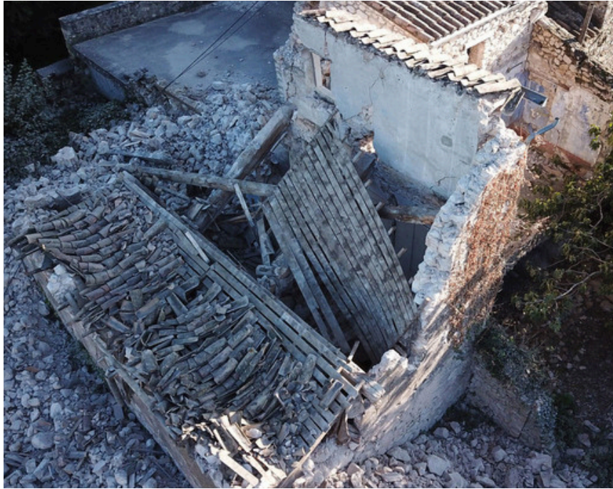
Séisme du Teil - Habitation endommagée à la Rouvière, 11 novembre 2019
