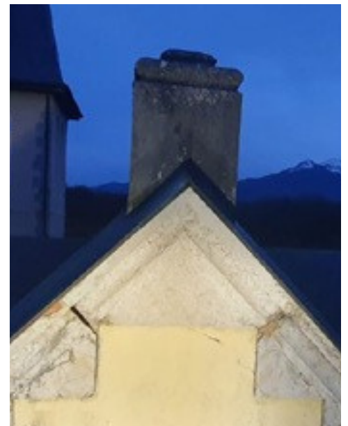
Façade de l'église après la chute de la croix
